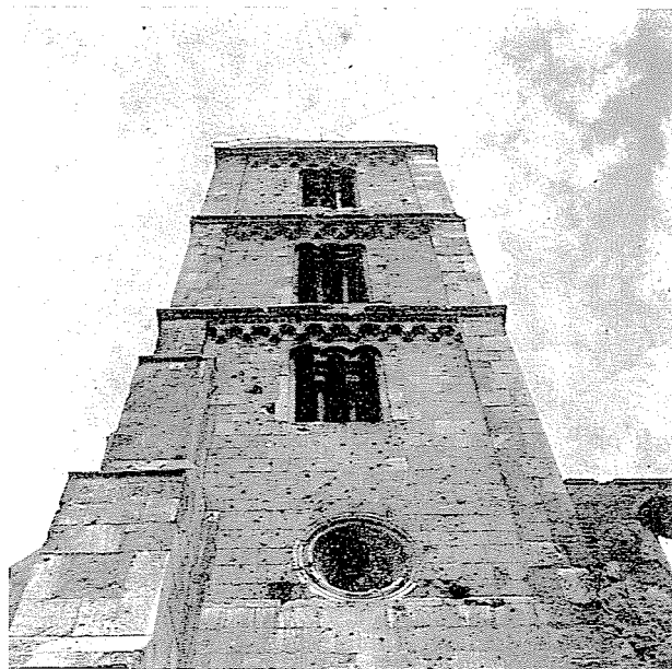
Abb. 8. Maßänderungen des Stützpfeilers und der Lisene auf der Südseite des Südturms
