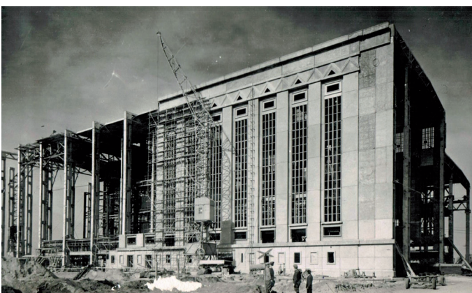
Fig. 17. Tiszapalkonya power station. Structure. Designers: Gyula Mátrai, Károly Pászti, László Vasek, László Bereczky. 1952-1957. (By kind permission of Foundation for Modern Industrial Architecture – IPARTERV Photo Archive / A (Modern) (Ipari) Építészeti Alapítvány – IPARTERV Fotóarchívum)
