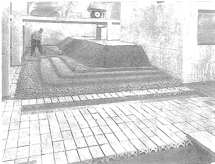
Abb. 8. Das geschlossene Langsamfilter im Bau der Zürcher Wasserwerke
