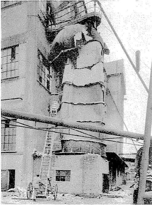
Abb. 4. Der eingeknickte Behälter mit der Isolationsschicht
