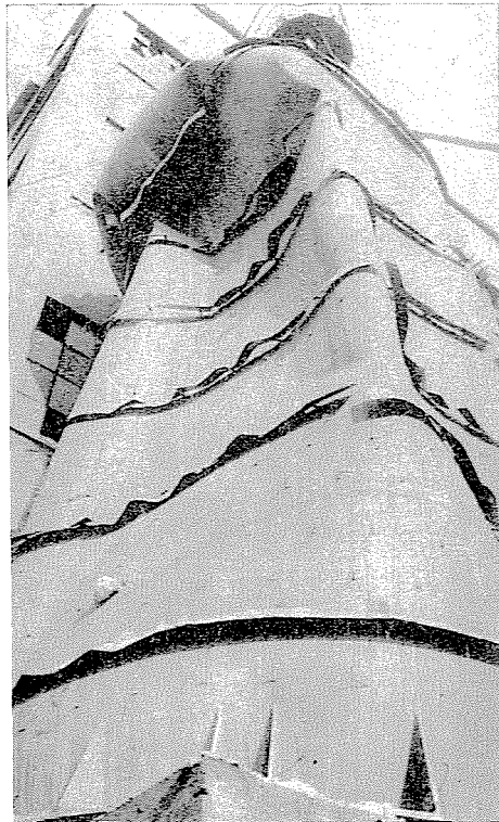
Abb. 5. Der eingeknickte Behälter nach Entfernung der Isolationsschicht
